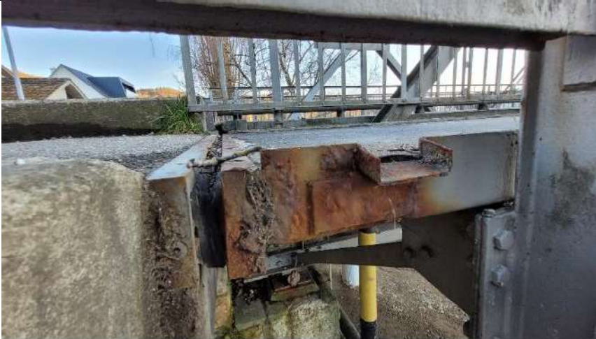
Bild 8: Strassenentwässerung und Fahrbahnübergang (defekt)
