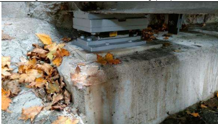
Bild 1: Lager Neuhausen unterwasserseitig (neu)
