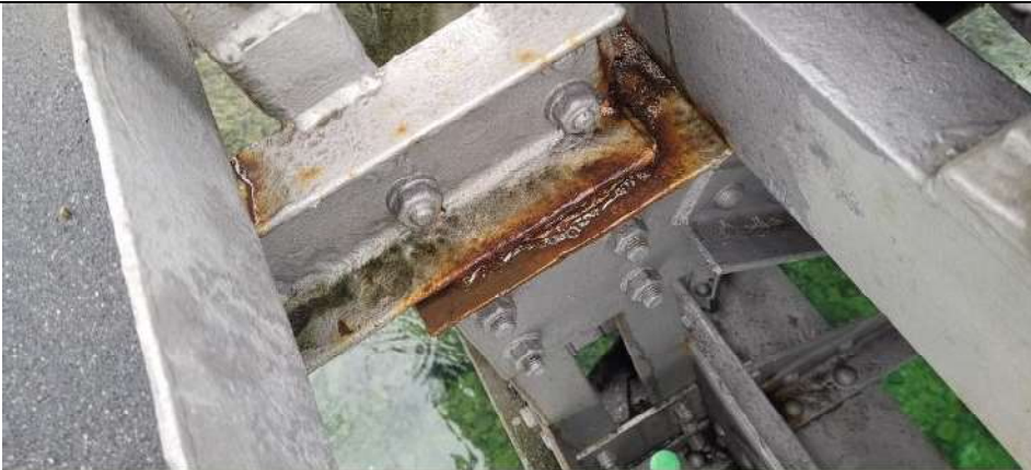
Bild 6: Anschluss Fussgängersteg an Hauptbrücke mit stehendem Wasser
