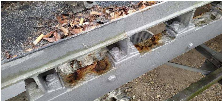
Bild 5: Randträger Fahrbahn mit starker Korrosion
