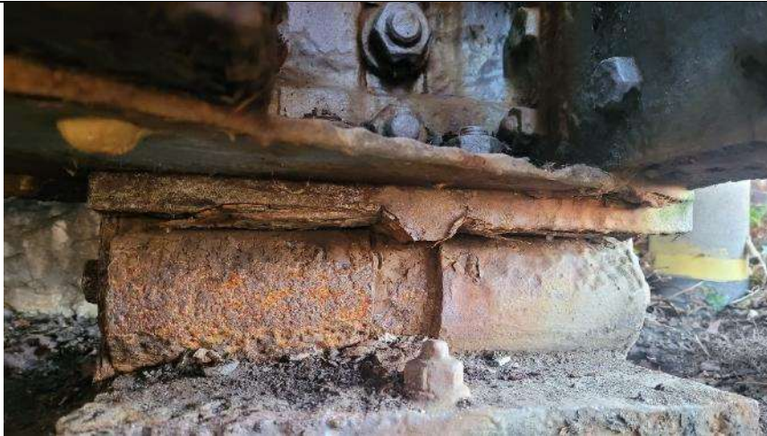
Bild 11: Lager Neuhausen (defekt)
