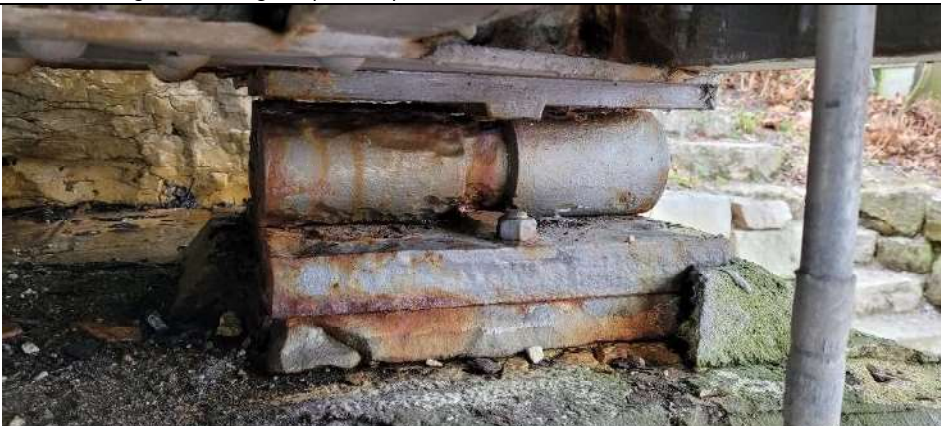
Bild 10: Lager Flurlingen (defekt)
