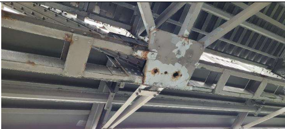
Bild 3: Durch Korrosion entstandene Löcher in Knotenblech
