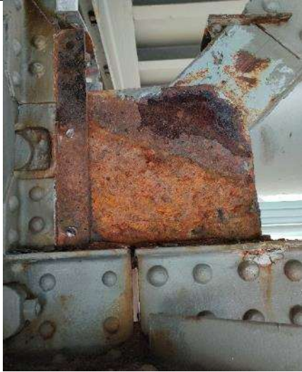
Bild 7: Ansicht von hinten, Abdeckung entfernt (starke Korrosion)
